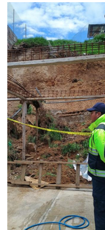
Imagen 21. Recorrido en vivienda, por afectaciones debido a deslizamiento de suelo en Santa María Zolotepec.
