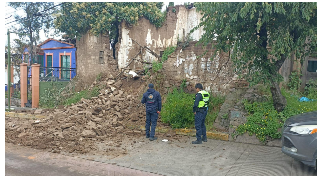
Imagen 17. Identificación de vivienda vulnerable por caída de material.
