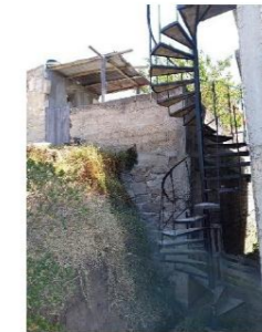
Imagen 6. Empuje de tierra, causando daños en los muros de las casas.
