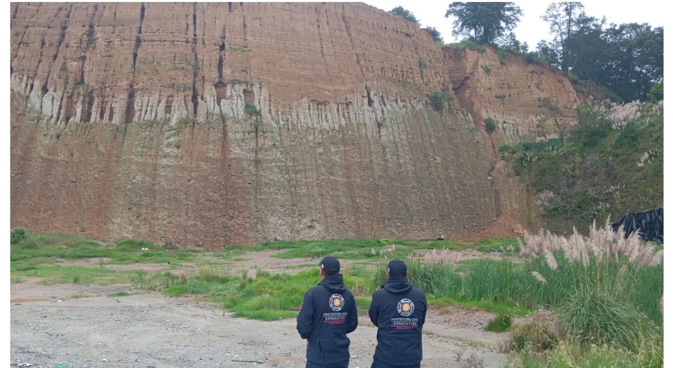
Imagen 16. Recorrido en mina, por colapso de suelo.
