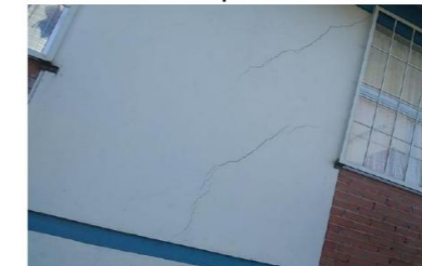
Imagen 8. Agrietamiento por sismos en el Jardín de Niños Luisa Isabel Campos Jiménez Cantú.
