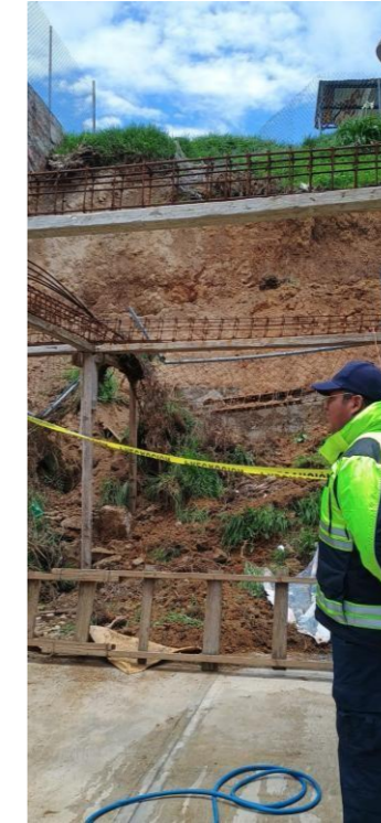
Imagen 21. Recorrido en vivienda, por afectaciones debido a deslizamiento de suelo en Santa María Zolotepec.
