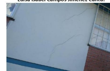
Imagen 8. Agrietamiento por sismos en el Jardín de Niños Luisa Isabel Campos Jiménez Cantú.
